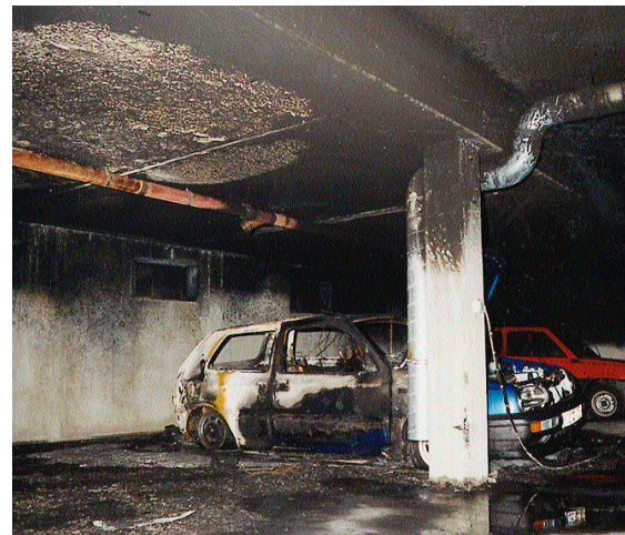
Eine häufige Brandursache in Tiefgaragen: Brandstiftung
